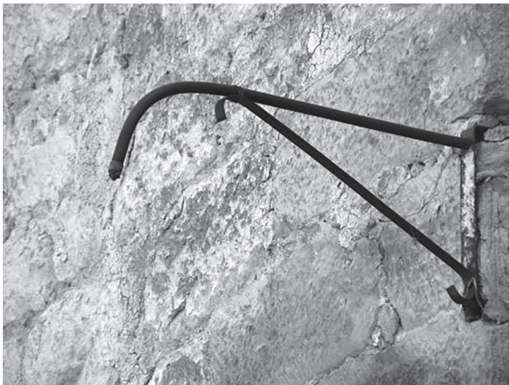
SopORTE para luminaria, emplazado en fachada de la Iglesia Parroquial
