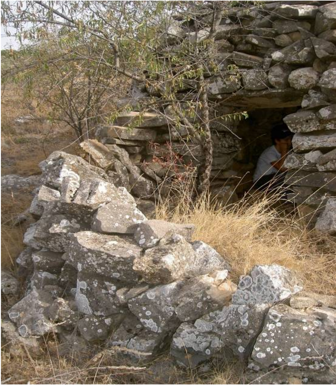
Detalle de la entrada. Dintel en la apertura de acceso y patín.
