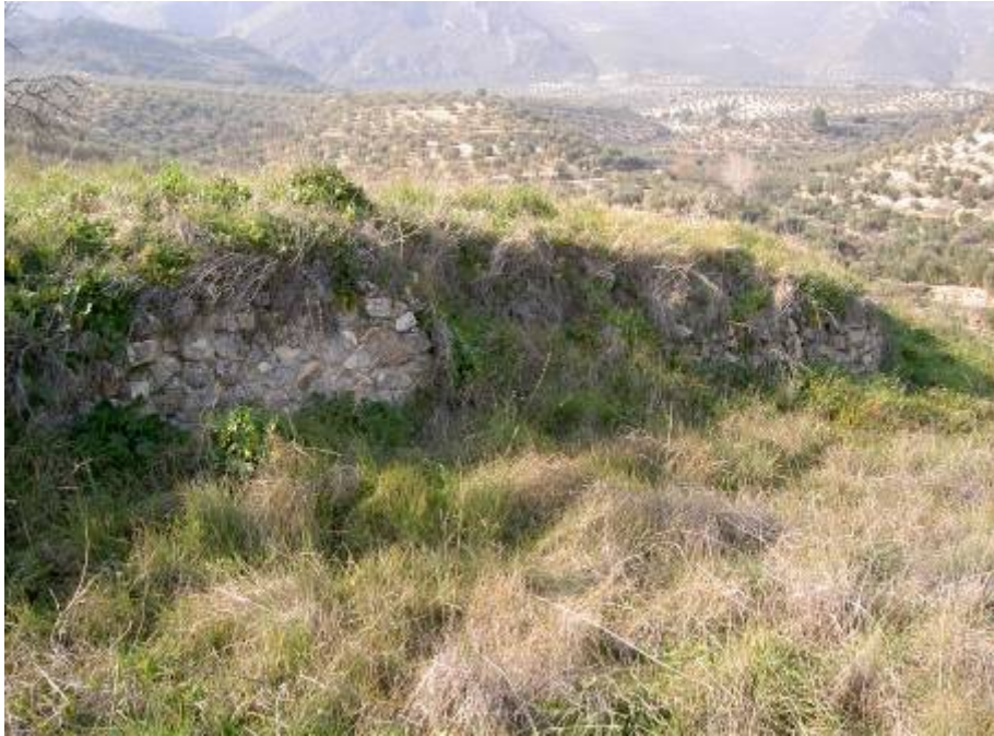
Muro de sujección de la parte este. Muy deteriorado
