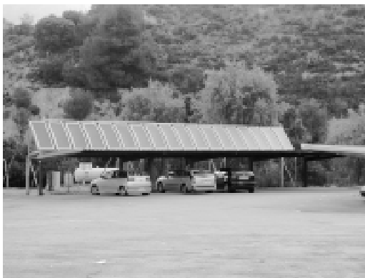
Instalación Solar Termina para agua caliente sanitaria.
