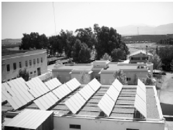
Paneles Solares Térmicos en edificio de la Diputación Provincial de Jaén. Fotografía: Pepe Vico.
