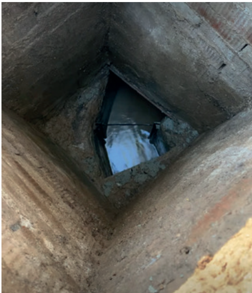
Arqueta donde se captan las aguas del Horado. Ahí existe una compuerta que regula el caudal de agua que llega hasta los depósitos municipales.
