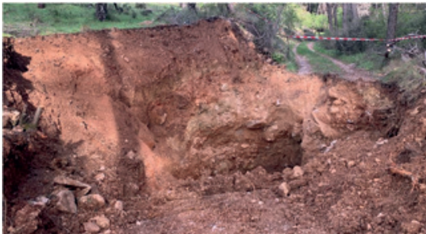
El Horado derrumbado,
